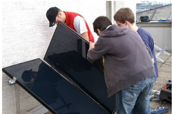
Aufbau der Real-Photovoltaik-Anlage
