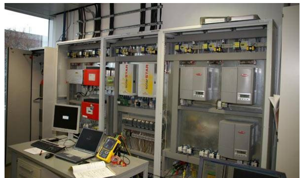
PV-Anlage: Wechselrichter, Messungen
