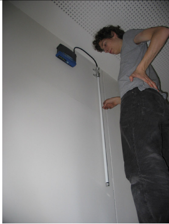
Die Montage eines Access Points und Antenne als Verstärkung
